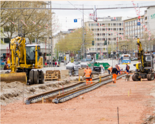
Stand 2. Mai 2017: Haltestelle Roter Turm – Die ersten Meter Gleis sind bereits verlegt. Sie werden höhen- und lageseitig ausgerichtet. Mit speziellen Spindeln kann die Höhe des Gleises millimetergenau ausgerichtet werden. Anschließend wird der Gleisbereich betoniert.
