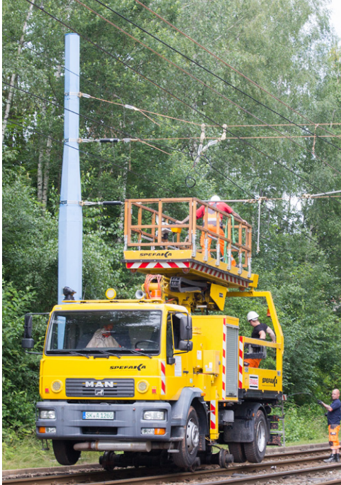
Die Anbringung von Fahrdraht- und Tragseilzug waren die letzten Arbeiten, bevor die Strecke ab dem 1. August 2016 wieder befahren werden konnte.
